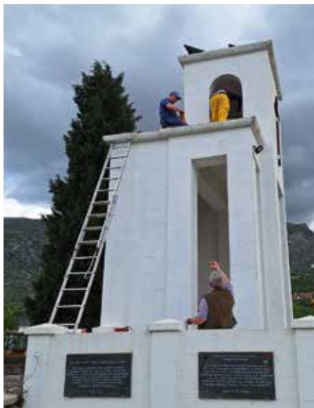
Die Solarstromanlage auf der Italienischen Kapelle wurde wieder funktionsfähig gemacht
